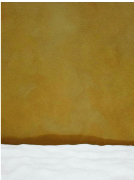
Der Putz ohne Hydrophobierung reagiert sensibel auf Feuchtigkeit. So trocknet er aber auch schnell wieder die Witterungs- und Baufeuchte ab.
