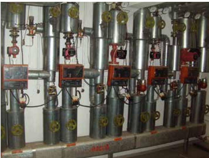
Die Pumpen hatten eine Leistung von rund 700 Watt ...
