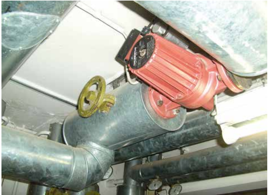
Die eigentlich nicht erforderliche Ladepumpe nahm konstante 140 Watt auf. Eine hydraulische Weiche war nicht vorhanden.
