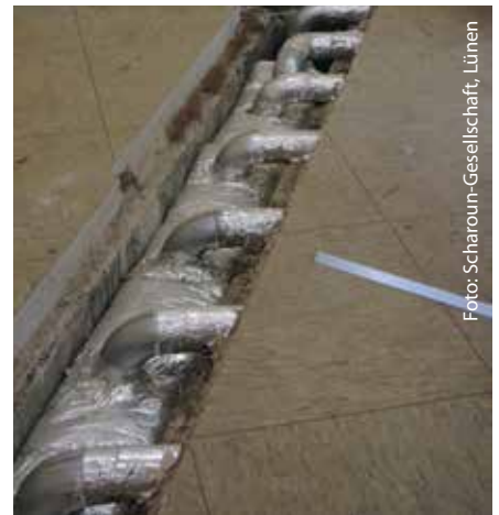
Der Verteilerkanal für die Warmluft musste erneuert werden, während die davon in Scharen abgehenden Blechrohre gereinigt und erhalten werden konnten.
