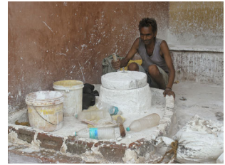
Heute wird das kulturelle Erbe handwerklich saniert. Der gebrannte Kalk kommt in Säcken auf die Baustelle, wird eingesumpft, von Hand gemahlen und bis zu acht Mal aufgetragen. Foto: Achim Pilz
