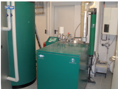
Mini-Blockheizkraftwerk (Foto: Iris Ullrich)
